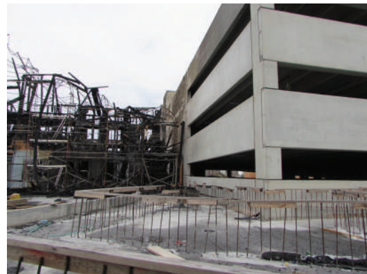
Fig. 2: Otra vista de los daños por incendio a los apartamentos con estructura de madera.
