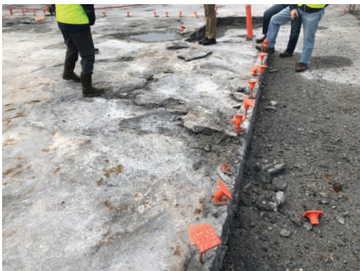
Fig. 3: Daños superficiales (desprendimiento) en el nivel del pódium debido al incendio.
