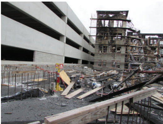
Fig. 1: Daños causados por el incendio a los apartamentos en Riverworks en Eastern Wharf.
